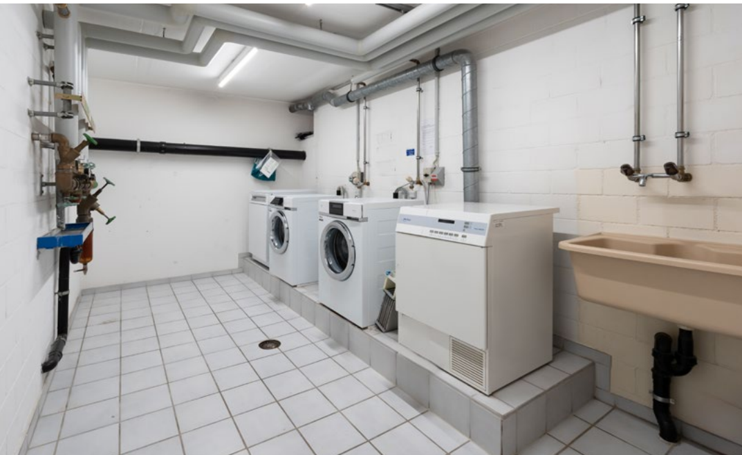
Waschküche (gemeinsame Nutzung), Untergeschoss
