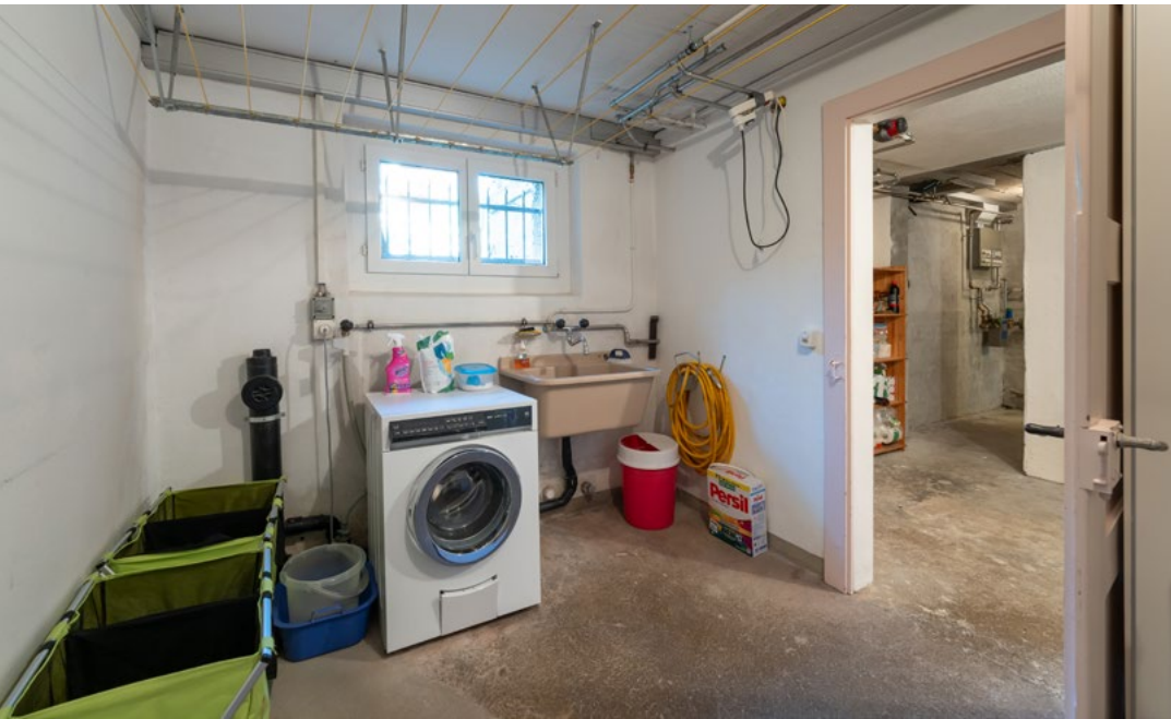
Waschküche mit Secomat, Untergeschoss
